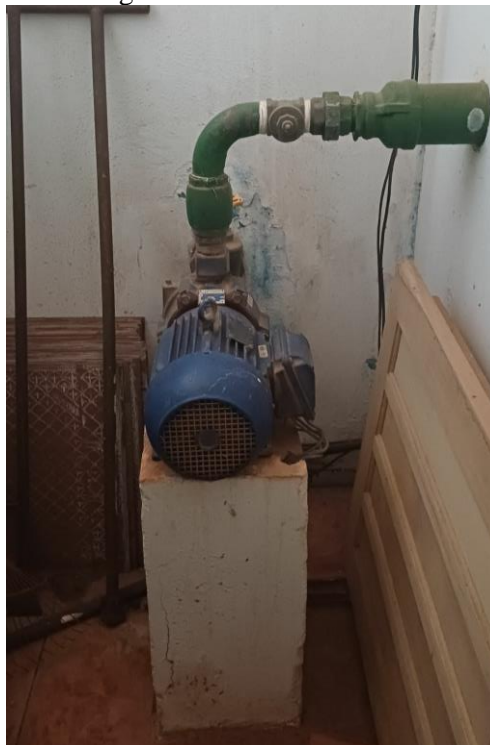
Figura 74- Vista da EEAT.
