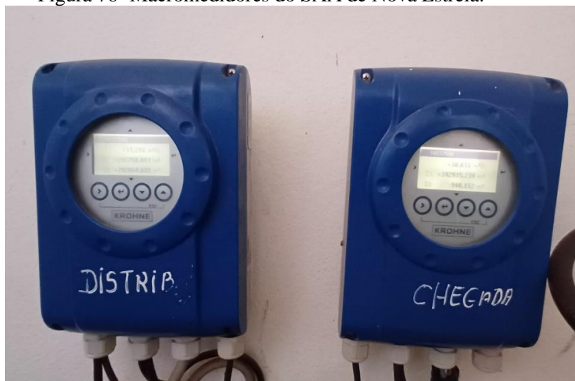
Figura 76- Macromedidores do SAA de Nova Estrela.
