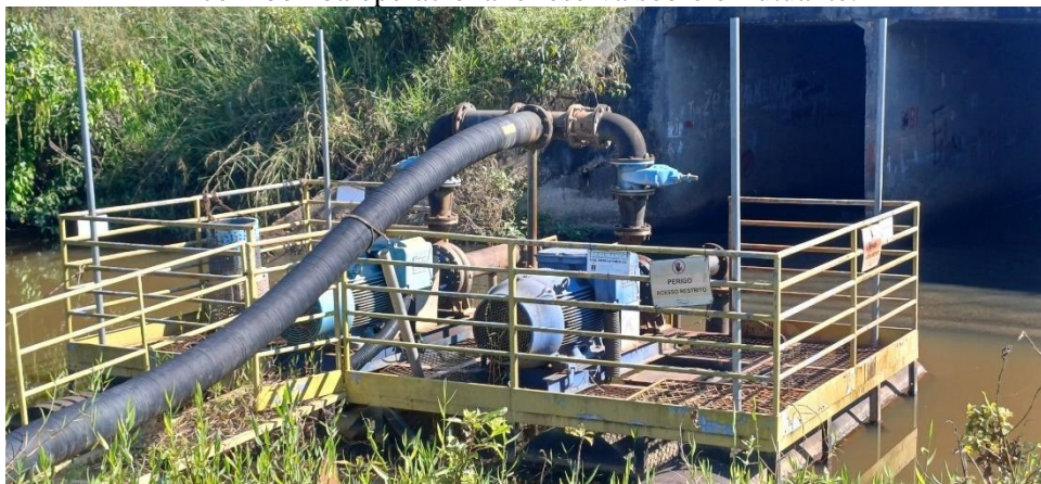
Figura 33- Vista da Elevatória de água bruta da captação do rio Manicoré, com bomba operacional e reserva sobre o flutuante.
