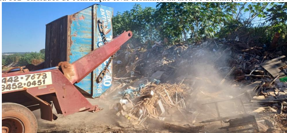
Figura 182- Resíduos de construção civil destinado na área de destinação de resíduos verdes
