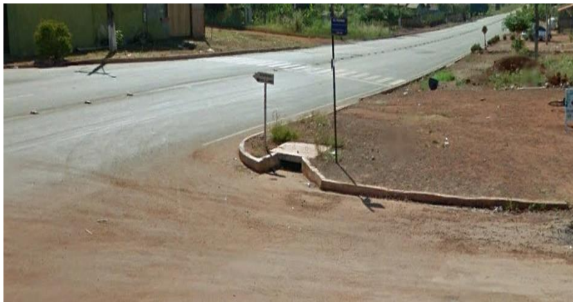
Figura 153 – Boca de lobo de guia, na Av. Araribóia
