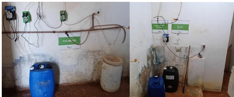
Figura 69- Dosagem dos produtos químicos.
