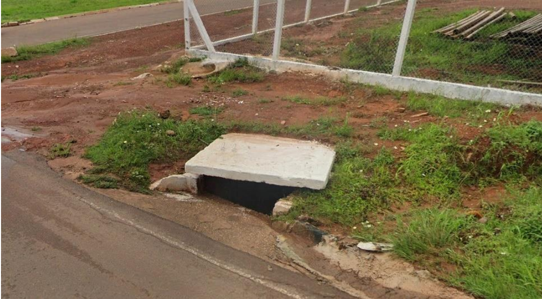
Figura 148 – Boca de lobo de guia, na Av. 25 de Agosto
