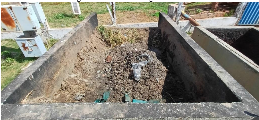
Figura 91- Leio de secagem de lodo.
