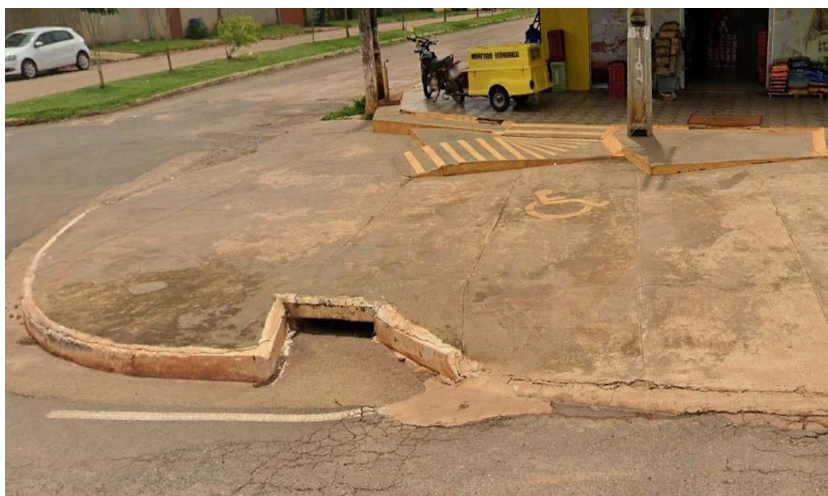
Figura 154 – Boca de lobo de guia, na RO-010.
