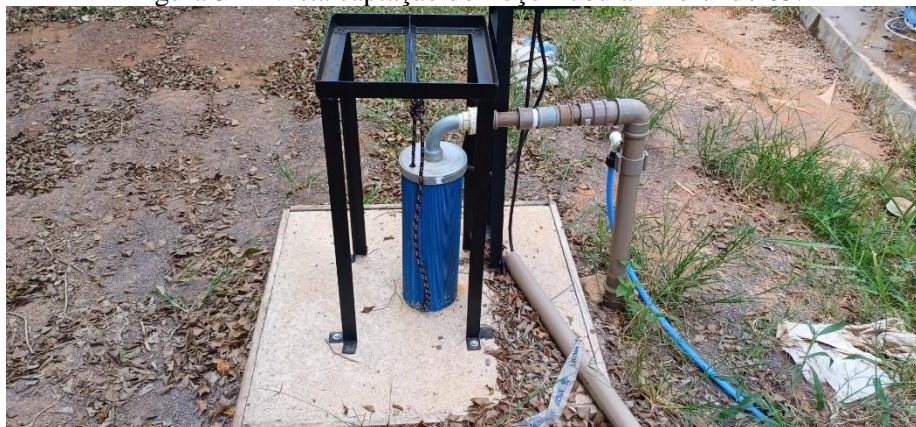
Figura 32 - Vista captação do Poço Tubular Profundo 03.
