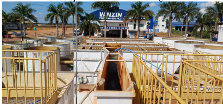
Figura 41- Vista das Estações de Tratamento de Água de Rolim de Moura.
