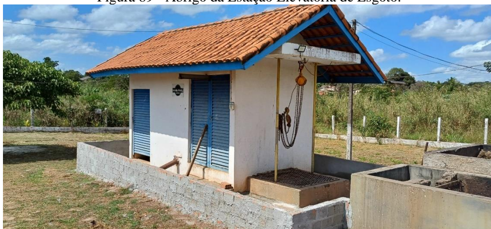
Figura 89 - Abrigo da Estação Elevatória de Esgoto.
