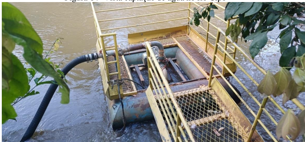
Figura 64- Vista captação de água no rio Cipó
