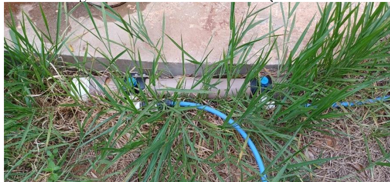
Figura 45- Dosador de cloro do Poço PTP 03.
