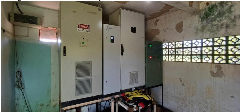
Figura 38- Vista externa dos painéis de comando da EEAB rio Manicoré.
