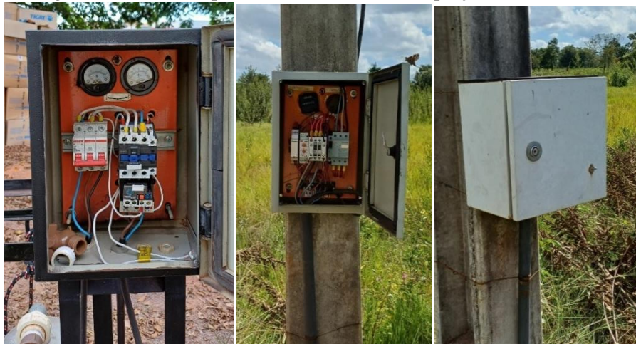
Figura 39: Vista dos painéis de comando das captações subterrâneas.
