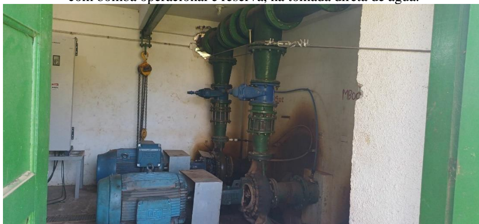
Figura 34- Vista da Elevatória de água bruta da captação do rio D'Alincourt, com bomba operacional e reserva, na tomada direta de água.
