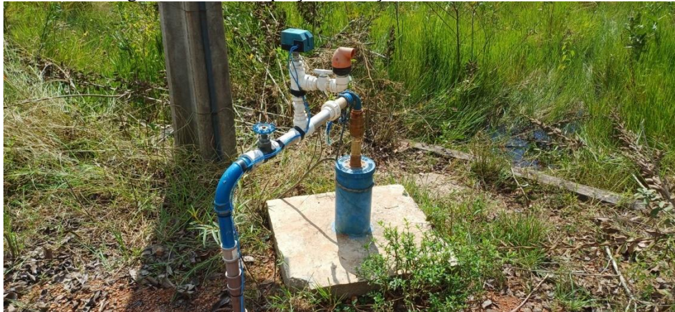
Figura 31- Vista captação do Poço Tubular Profundo 02.
