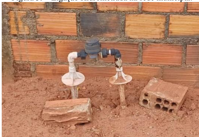
Figura 59 - Ligação Hidrometrada na sede municipal.
