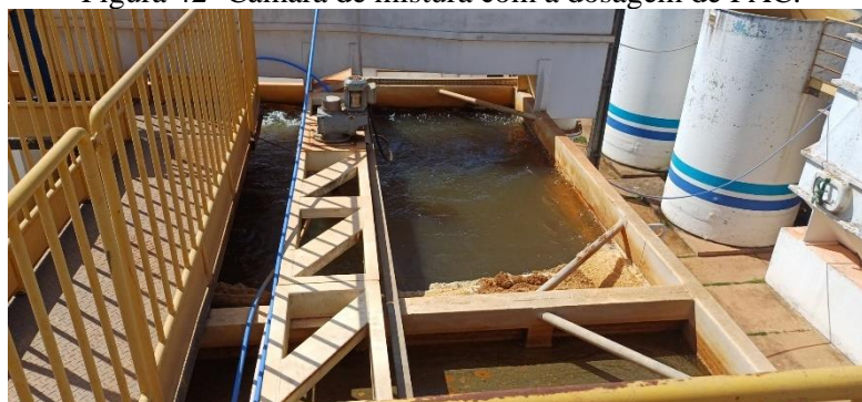
Figura 42- Câmara de mistura com a dosagem de PAC.
