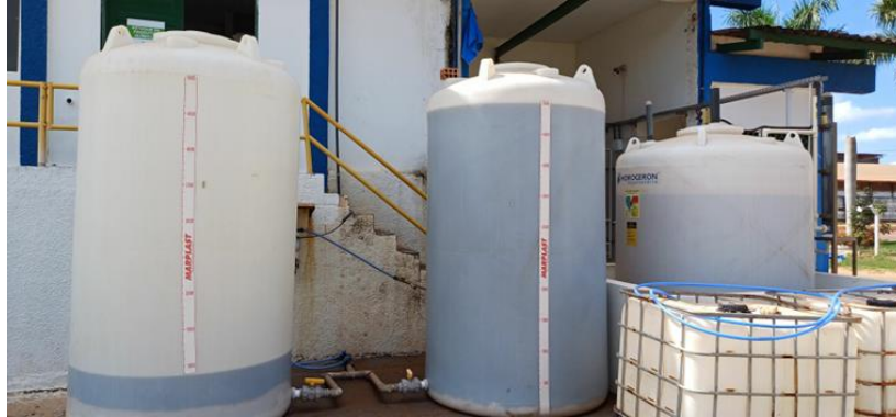
Figura 46- Armazenamento dos produtos químicos.
