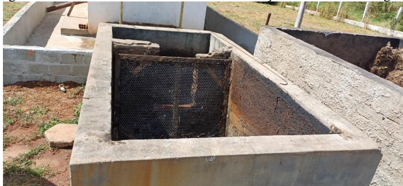
Figura 86- Gradeamento e desarenador da Estação Elevatória de Esgoto.
