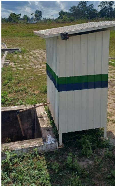
Figura 84 - Dosador de cloro.
