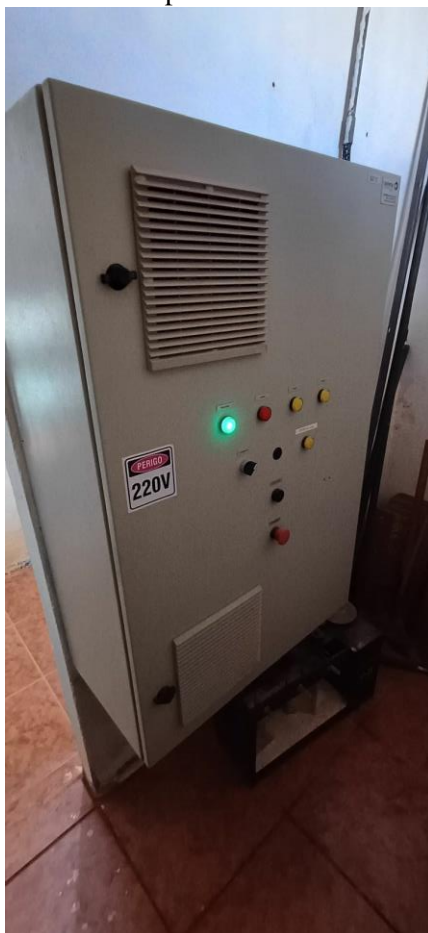
Figura 75- Vista do painel de comando da EEAT.
