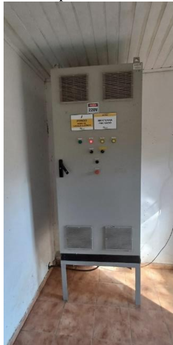
Figura 66- Vista externa do painel de comando da EEAB rio Cipó.
