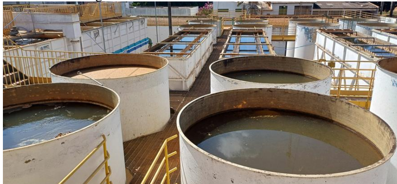
Figura 44- Floculadores da ETA de Fibra.
