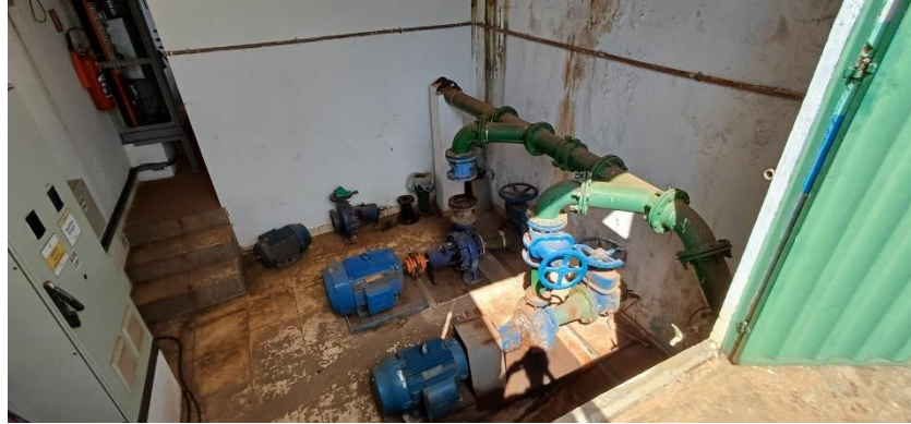
Figura 54 - Vista da EEAT.
