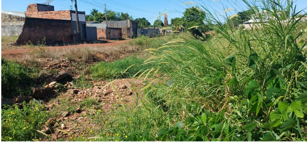
Figura 113 – Vista do Canal 5 no canteiro central da Av. Manaus, em trecho assoreado com presença de resíduos de construção civil.
