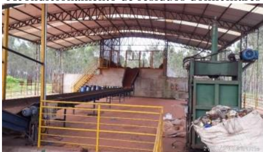
Acondicionamento de resíduos domiciliares
