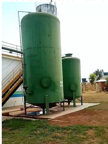
Figura 68- Vista das Estações de Tratamento de Água.
