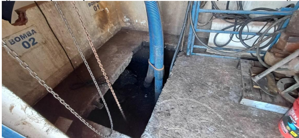
Figura 88 - Poço de sucção com as bombas submersas da Estação Elevatória de Esgoto.
