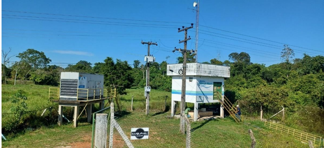
Figura 36- Abrigo onde ficam os painéis e as elevatórias de água bruta do rio D'Alincourt.
