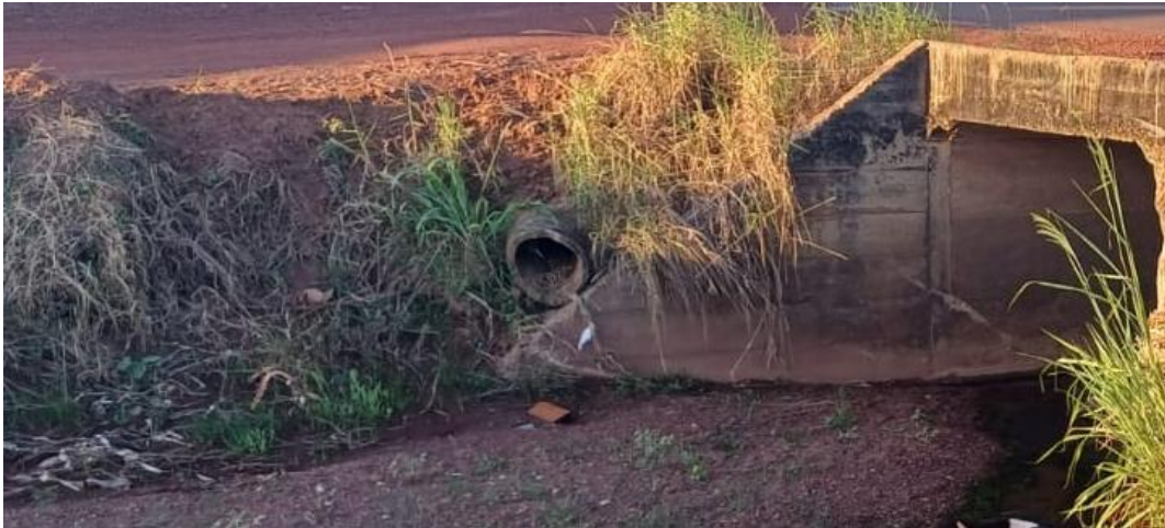
Figura 150 – Lançamento de águas pluviais na macrodrenagem natural sem dissipador de energia.
