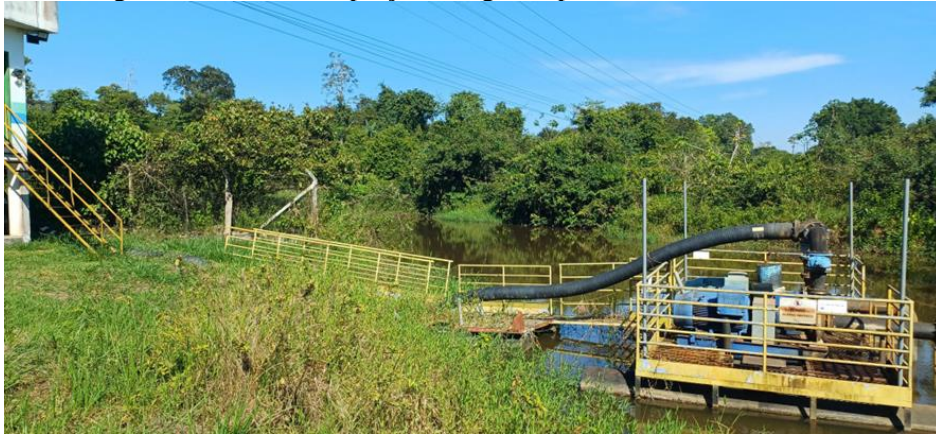
Figura 28- Vista da captação de água superficial no rio Manicoré.
