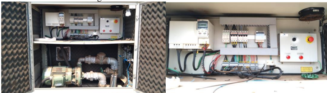
Figura 57- Painel de comando do booster.
