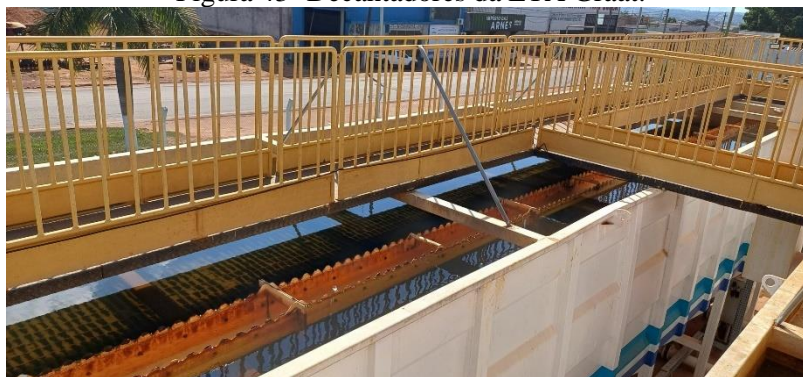
Figura 43- Decantadores da ETA Graat.
