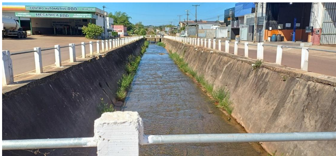
Figura 121 – Vista do igarapé da Encrenca em trecho retificado no canteiro central da Av. Fortaleza.
