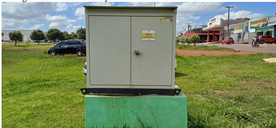
Figura 55- Vista da localização do booster do SAA de Rolim de Moura.
