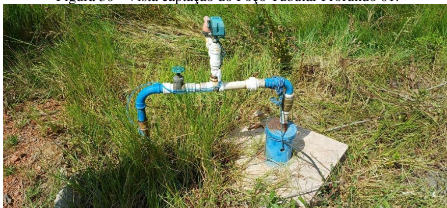
Figura 30- Vista captação do Poço Tubular Profundo 01.
