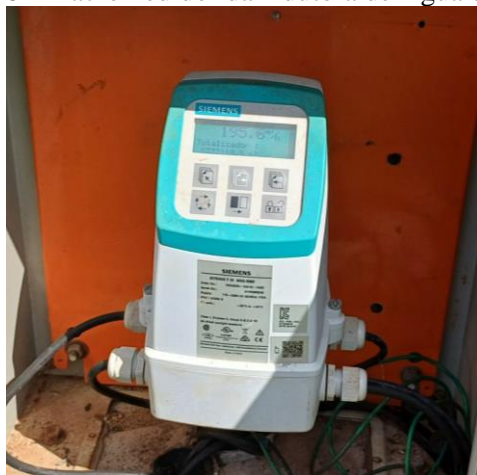
Figura 58- Macromedidor da Adutora de Água da EEAT.
