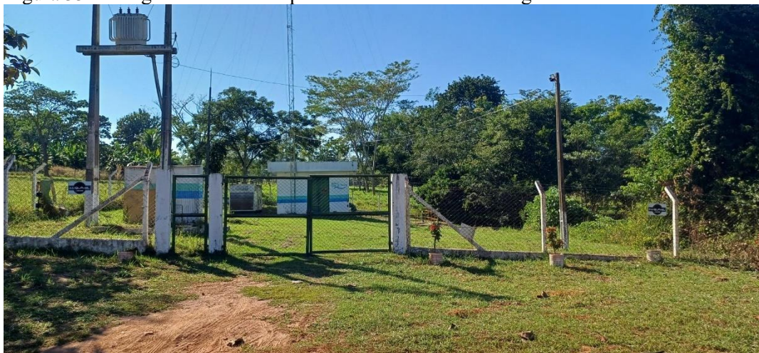
Figura 35 - Abrigo onde ficam os painéis e as elevatórias de água bruta do rio D'Alincourt.
