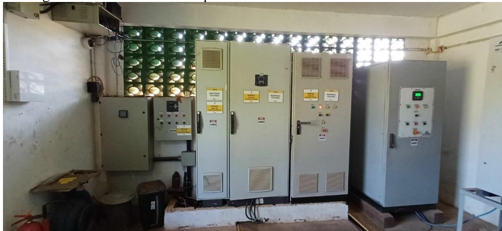
Figura 37- Vista externa dos painéis de comando da EEAB rio D'Alincourt.
