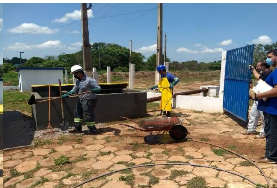
Fonte: Acervo próprio – Fiscalização processo operacional EEE . Foto 15.
